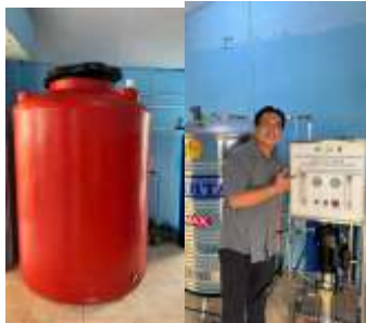
Gambar Toren penampungan air bersih dilengkapi sensor level air
